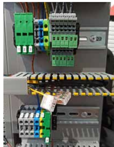
③ Particolare canalina
